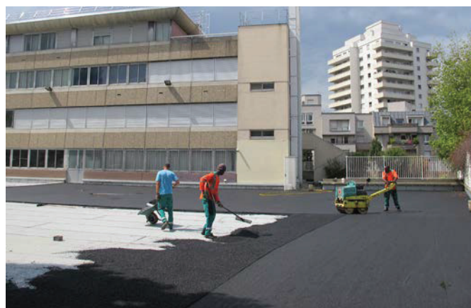
Rénovation de la cour de l'école Albert Cron, Le Kremlin-Bicêtre (94) – BET SECC
